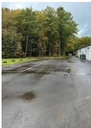
Renouvellement de la couche de roulement Rue de la Montagne à Koerich
